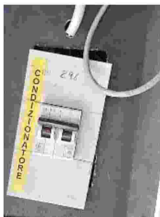
Fili elettrici 'volanti'
