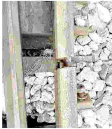
Il binario nuovo già rotto
